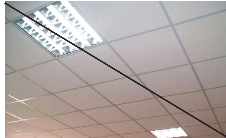
Плохо Открытые направляющие
